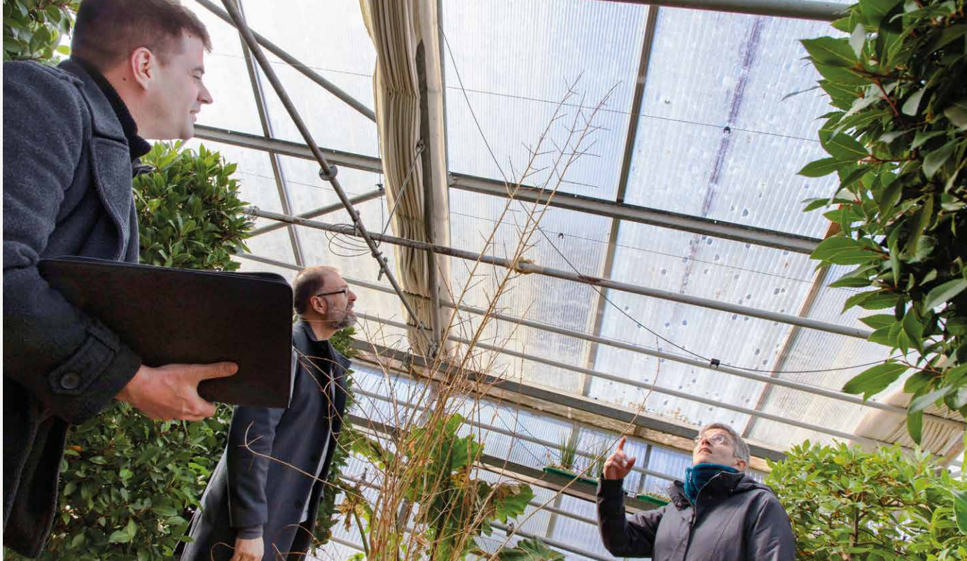
Dieses Gewächshaus in der Gemeinde Binningen wurde von Hagelkörnern durchlöchert.
